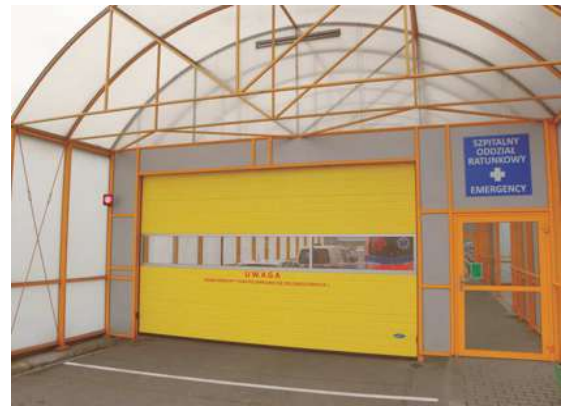
Nowe automatyczne bramy do podjazdu dla karettek wyposażone w sygnalizację świetlną
