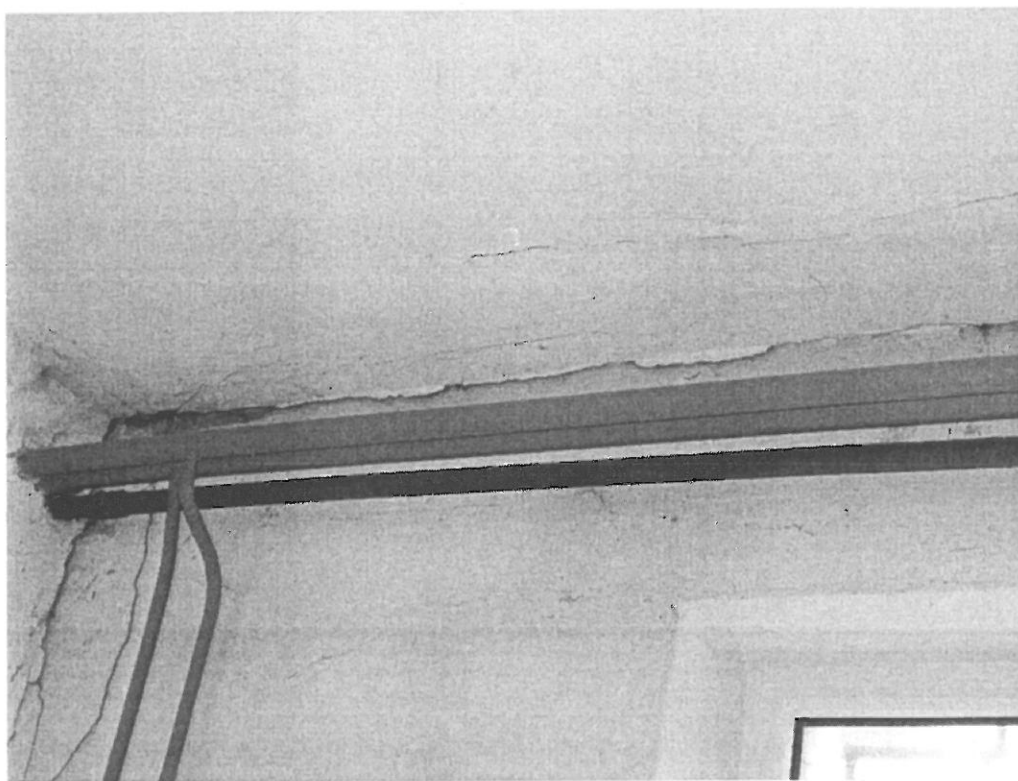
Fot.13 Rozwarstwienie między ścianami i stropem nad parterem
