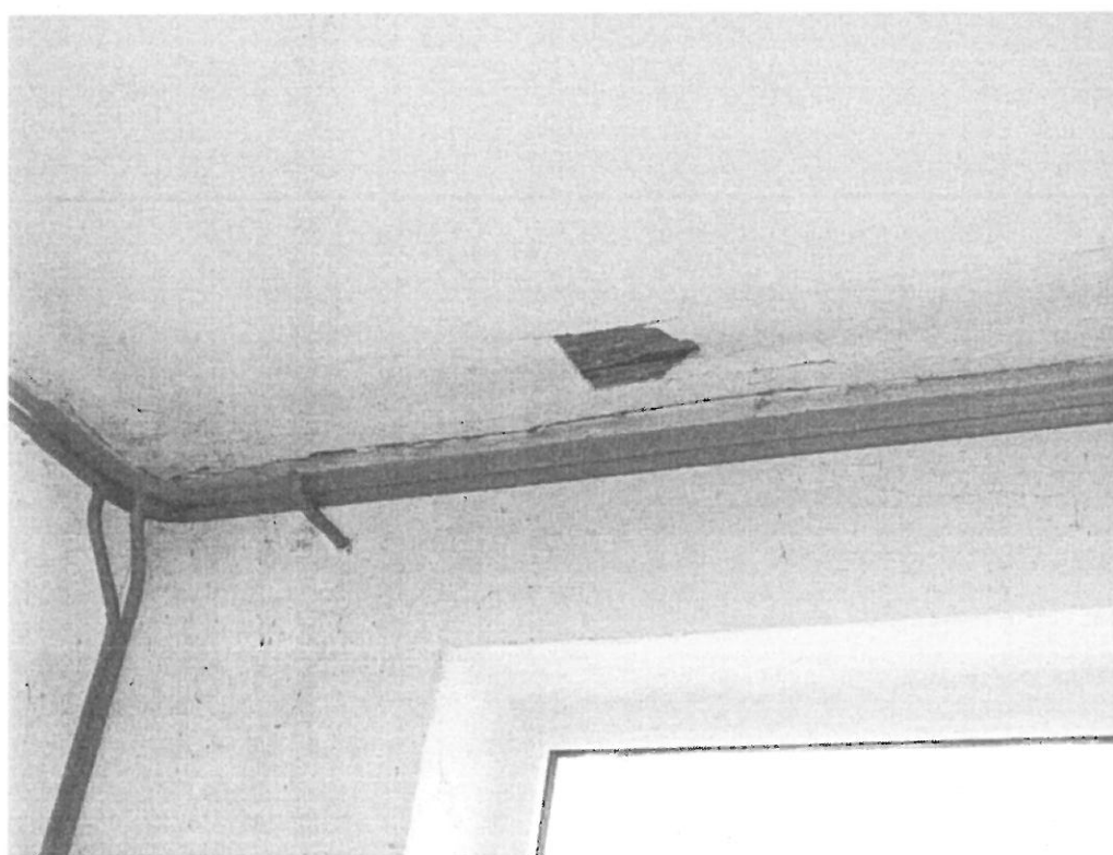
Fot.18 Rozwarstwienie między ścianą a stropem nad parterem
