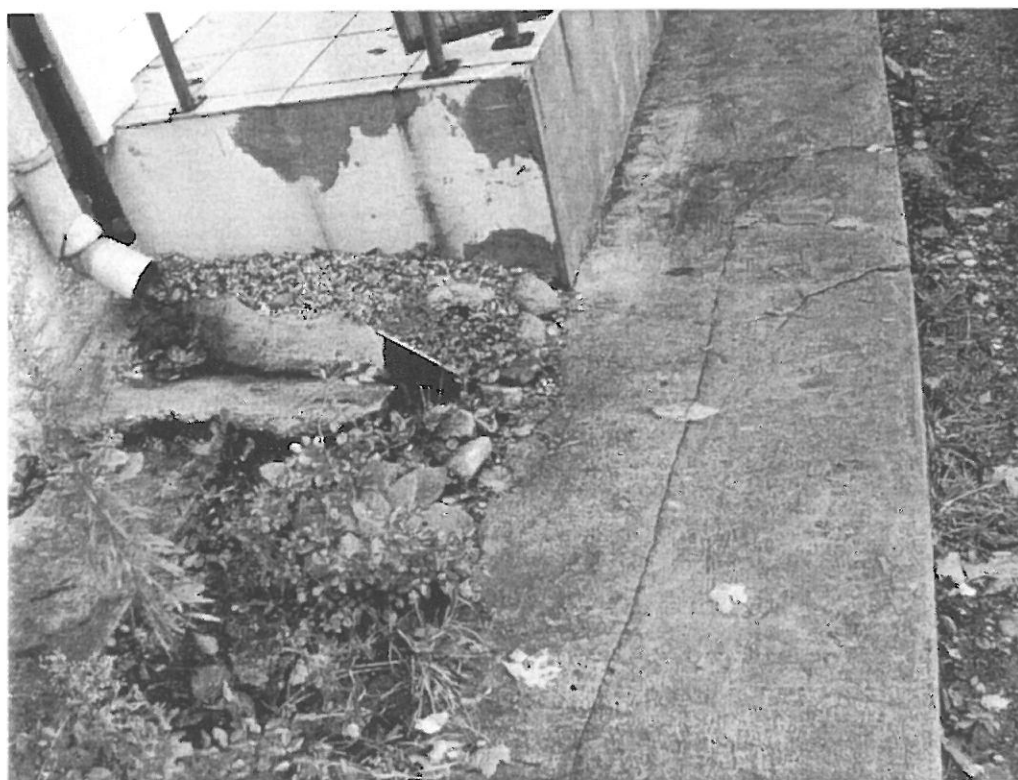
Fot.8 Wadliwe odprowadzenie wody z rury spustowej
