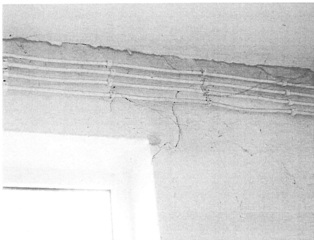
Fot.10 Pęknięte nadproże pomieszczenia na parterze
