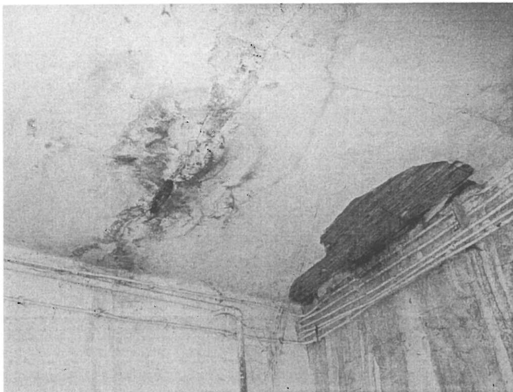
Fot.23 Zniszczenia tynku sufitu stropu nad parterem /pozostałość po zalaniu stropu/
