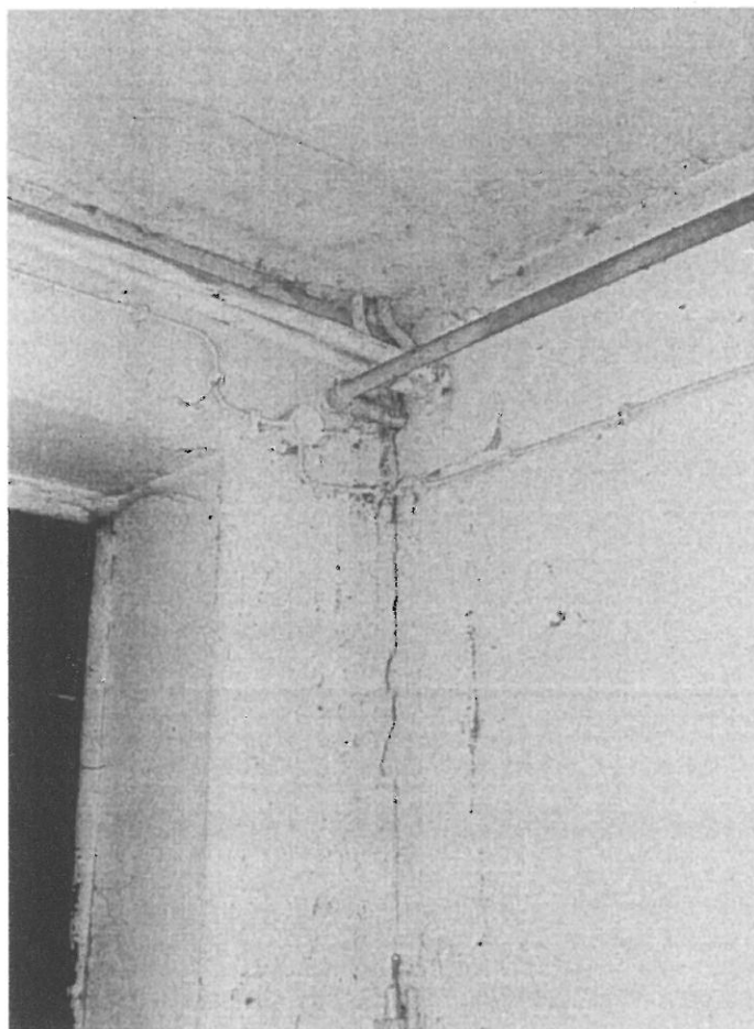
Fot.17 Rozwarstwienie między ścianami na parterze
