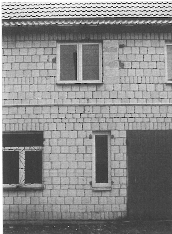
Fot.5 Rysy na ścianie północnej
