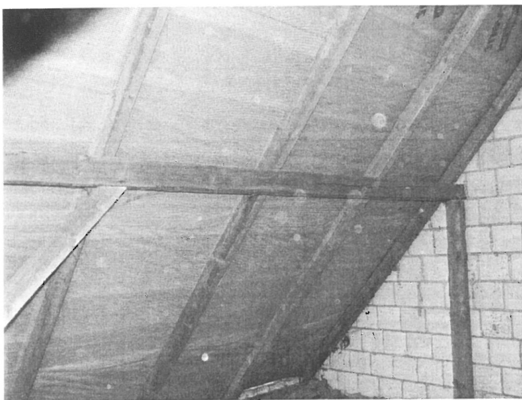
Fot.26 Fragment więźby dachowej /widoczne ugięcie płatwi/
