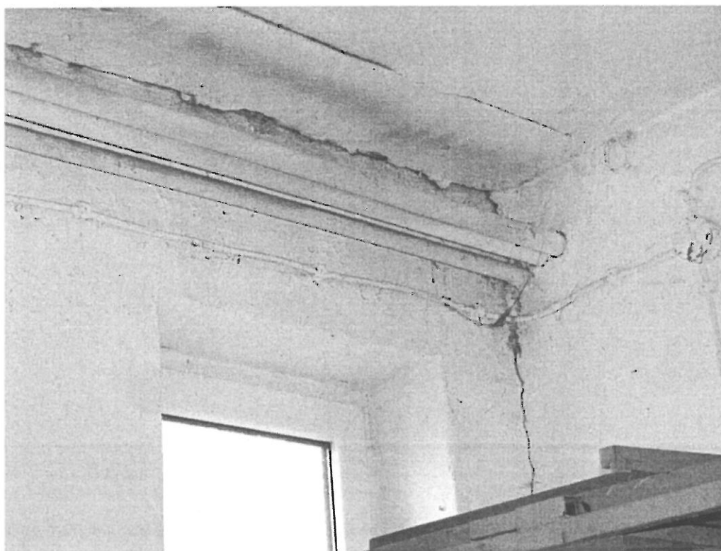
Fot.15 Rozwarstwienie między ścianami i stropem nad parterem
