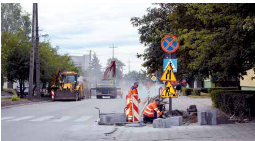
Na czas przebudowy ulic Parzęczewskiej i Targowej ruch odbywa się tam wahadłowo
