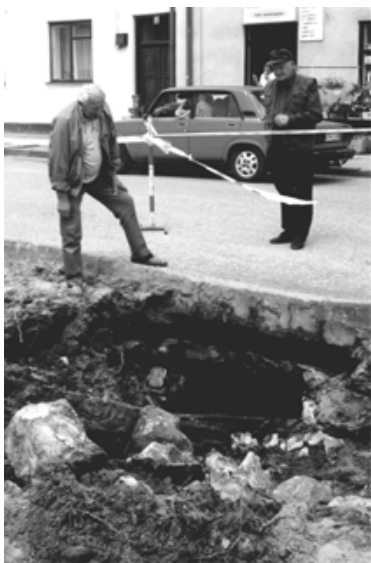
Zasypana studnia. Fot. R. Stojek
