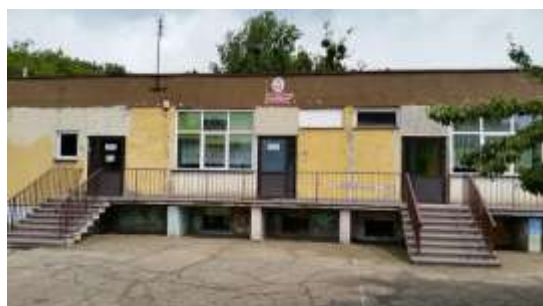
Fot.4 Wymagający przebudowy oraz termomodernizacji budynek Przedszkola Jarzębinka
