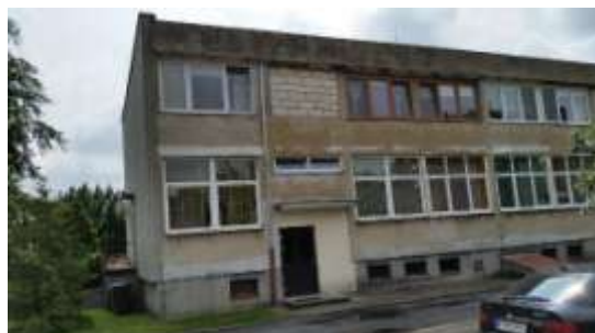
Fot.2 Wymagający termomodernizacji budynek Ośrodka Zdrowia
