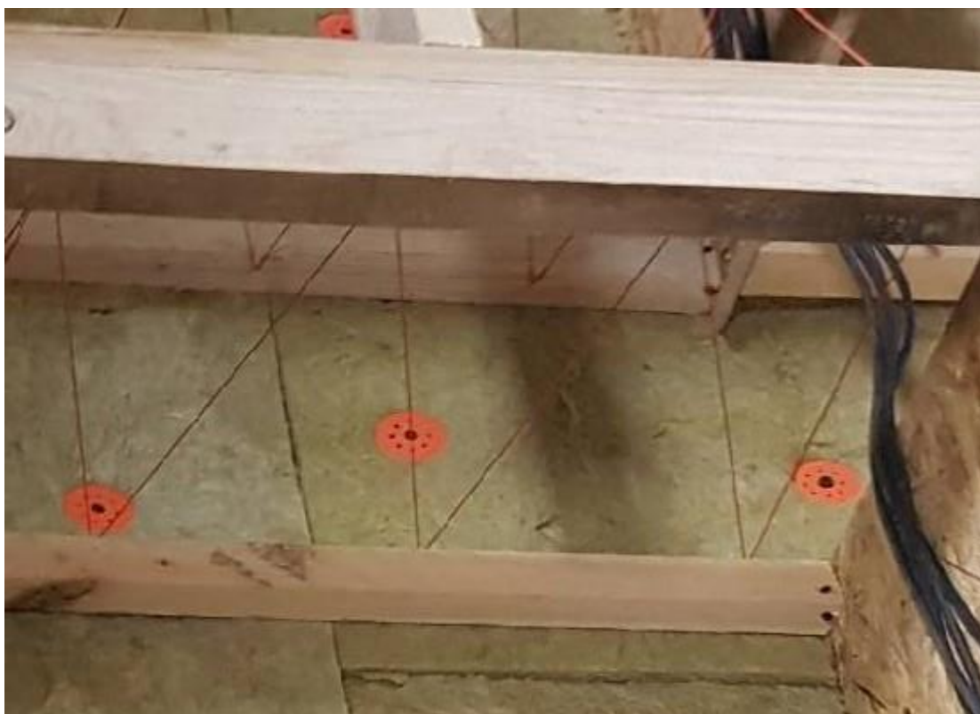
Rys. 36: Plecionka ze sznurka do podtrzymywania luźnej wełny mineralnej wypełniającej przestrzeń za płytą akustyczną.
